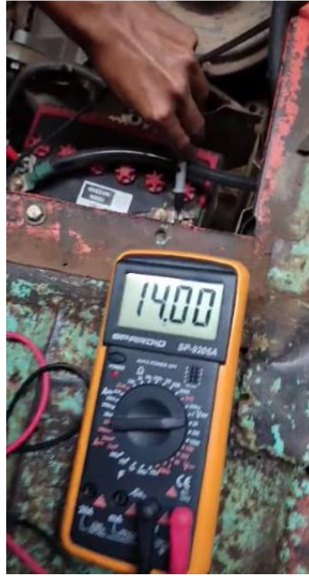
Gambar 4 Pemeriksaan Tegangan Baterai Saat Mesin Hidup
